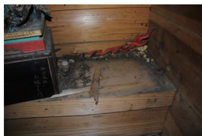
② 須弥壇にたまった塵に仏像から脱落した部材が混じっている様子
